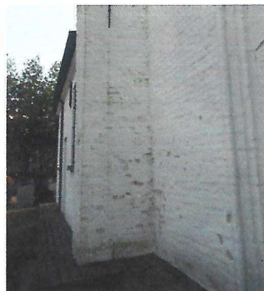
plaatselijk lichte schade
