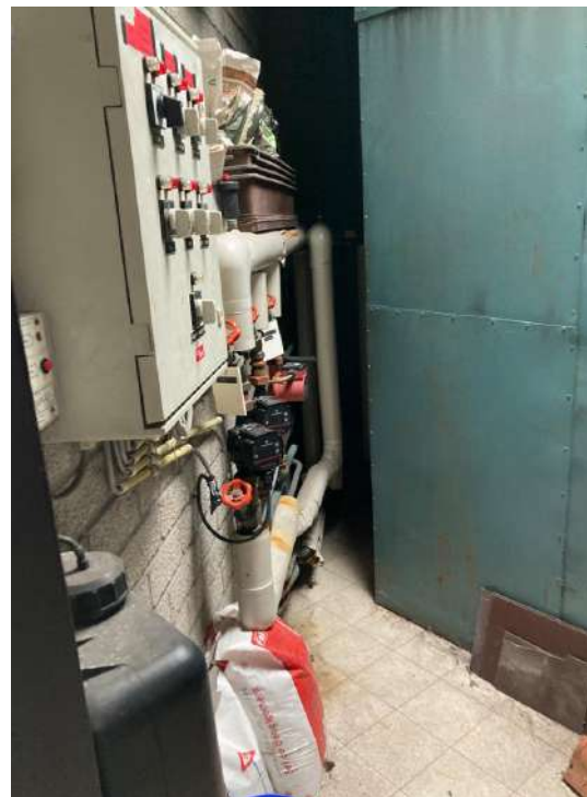
Fig. 105 en 106: Sint-Ludwinakerk verwarmingsinstallatie. IGEMO, 2025.
