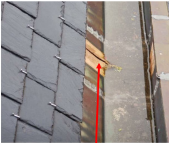
Dakvlak 10, voorbeeld van gescheurd rekstuk
