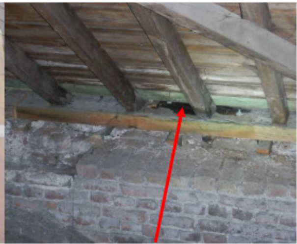
Dakvlak 10, voorbeeld van vochtplek op muurplaat
