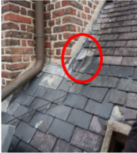
Dakvlak 10, ontbrekende leien
