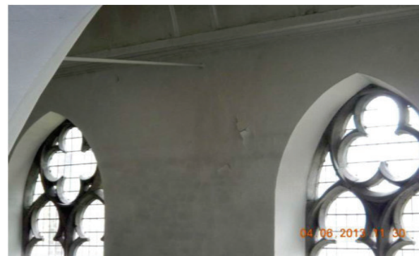
Licht vervuuld verwerk. Afgebladderd verwerk.
