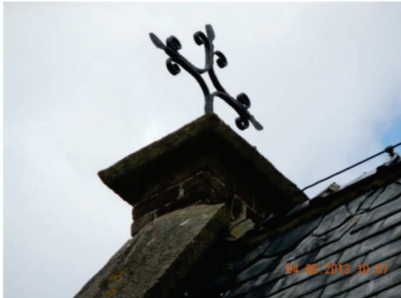
Roestig kruis en licht uitgeloozd voegwerk.
