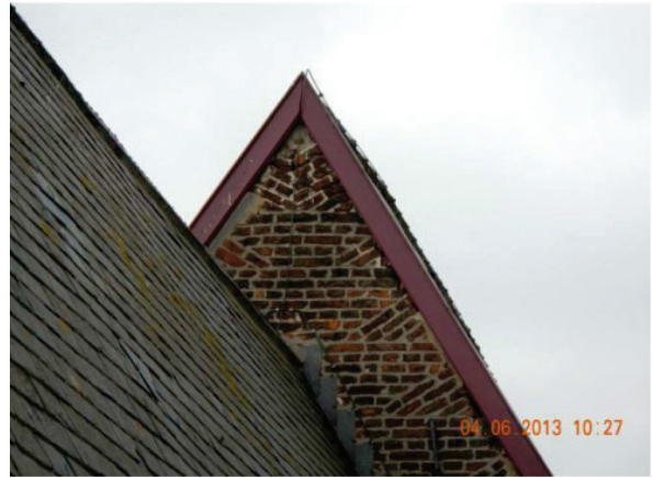
Licht uitgeloozd voegwerk aan oostelijke topgevel.
