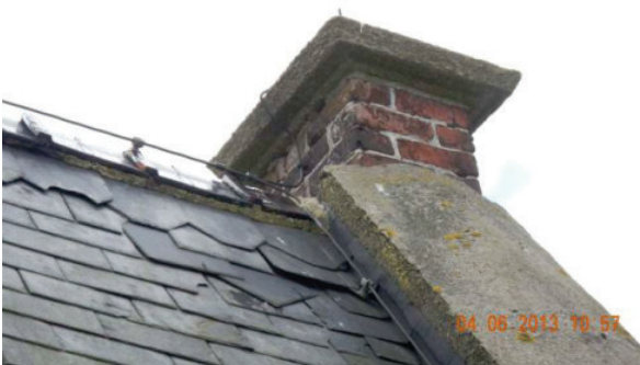
Licht uitgeloozd voegwerk bovenaan westelijke topgevels.
