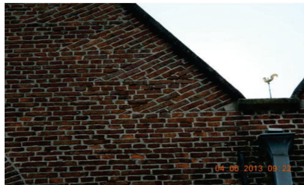
Voegwerk bovenaan westelijke topgevel is licht uitgeloozd. Bakstenen zijn licht afgeschilferd.
