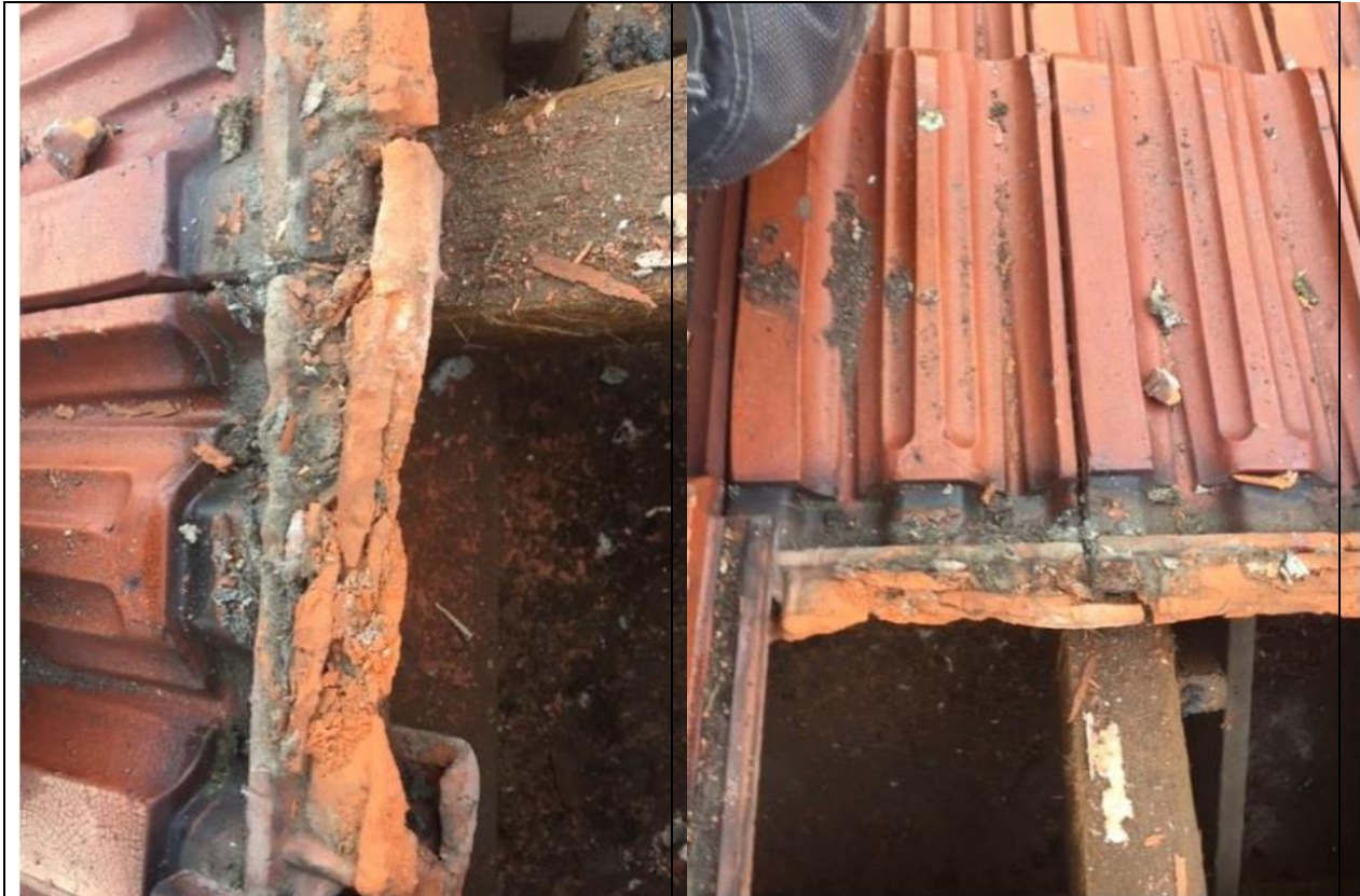
Figuur 2.3.14: dakinspectie: pannen in slechte staat.
