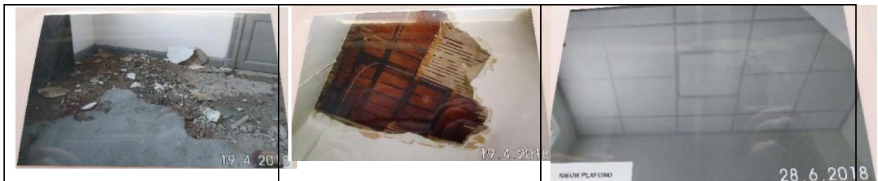
Figuur 2.3.13: beschadiging plafond sacristie
