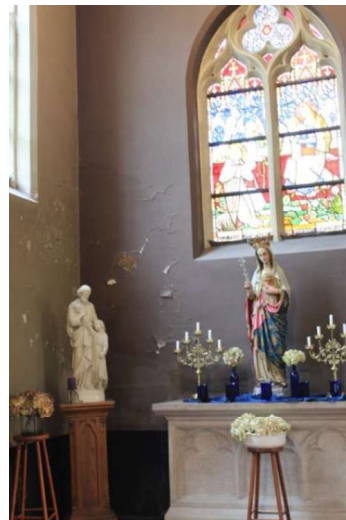
afbladderende verf aan de noordelijke zijkapel
