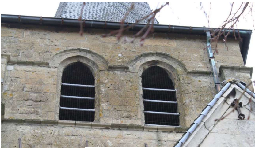
galmgaten kunnen bij restauratie vleermuisvriendelijk worden gemaakt
