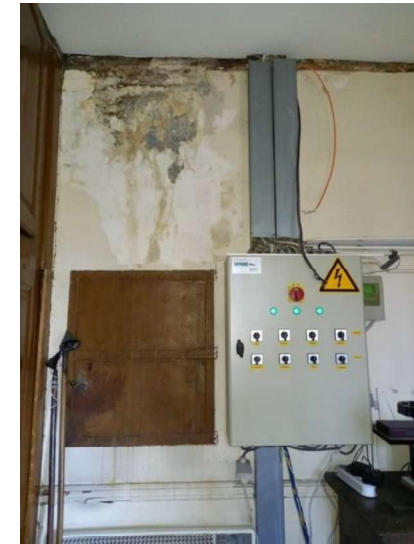
muren sacristie moeten nog drogen
