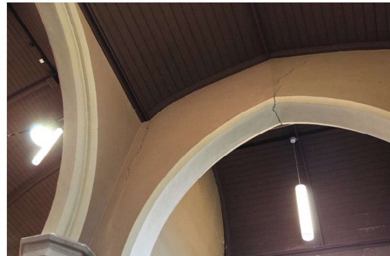
scheurvorming in de rechterzijbeuk
