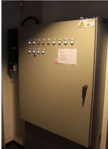
elektrische installatie (IOED Schelde-Durme 20/02/2025)
