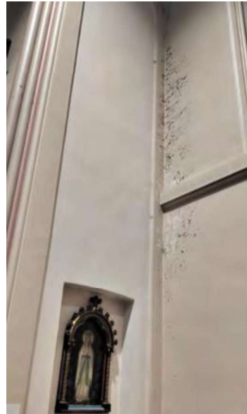
afbladderende verf bij eerste kapel aan de westzijde (© BRESSERS)
