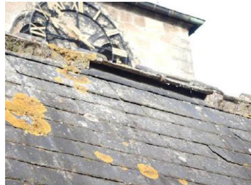
weggefallen mortel bij de nok
