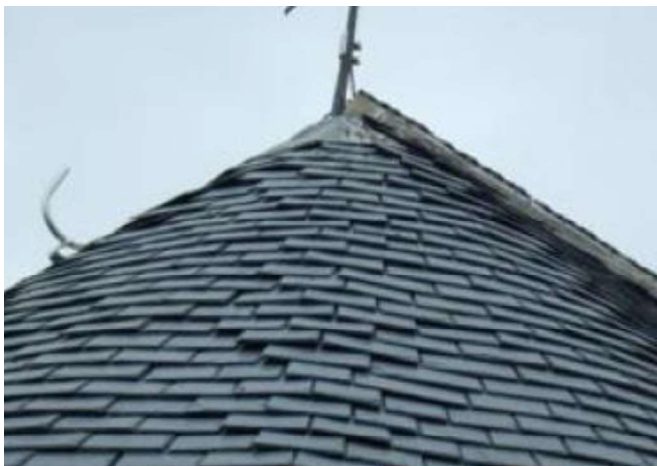
leien sluiten niet optimaal aan
