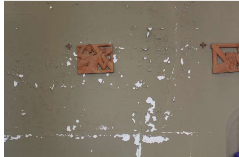
afbladderende verf aan de noordgevel
