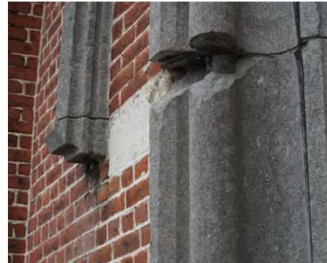
afgebroken stuk natuursteen door verroeste doek
