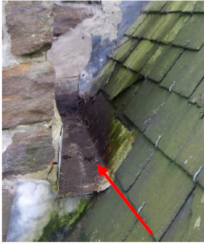
Dakvlak 8, gecorrodeerde zalinggoot
