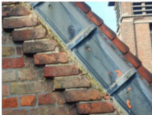
Meerdere kantpannen zijn gescheurd, onderdelen kunnen uitvallen
