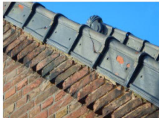
Meerdere kantpannen zijn gescheurd, onderdelen kunnen uitvallen
