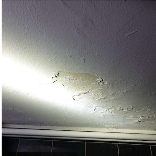
Afschilfering van de verflaag
