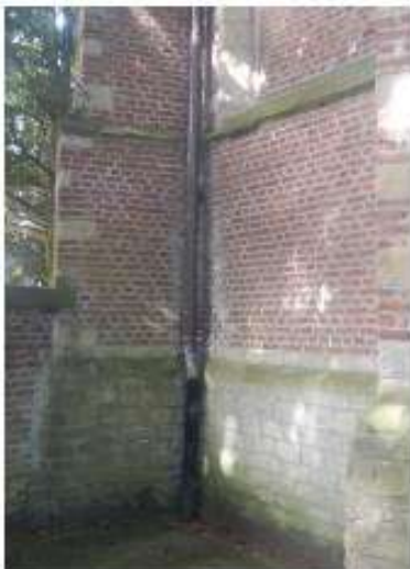
volume [2]-noord: beschadigd metselwerk achter afvoer
