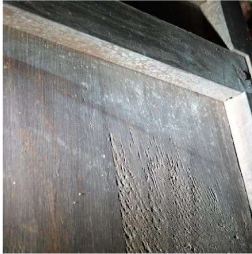
Oppervlakteschimmel achterzijde altaar
