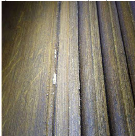
Stootschade bij houtimitatie aan de buitenzijde
