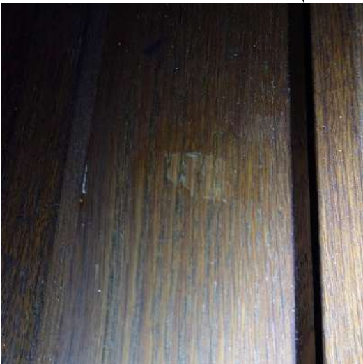
Schade beschermlaag door verwijderen plakband (deur sacristie)
