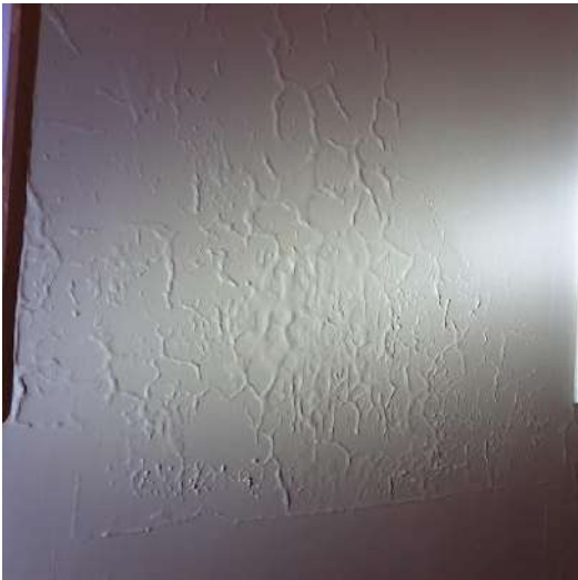
Zouten in de muur (noordwand bij statie VII)
