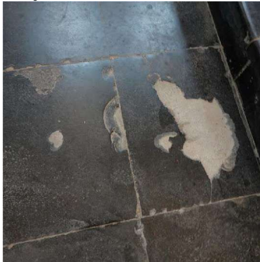
Invullingen met kalkmortel niet op kleur gebracht
