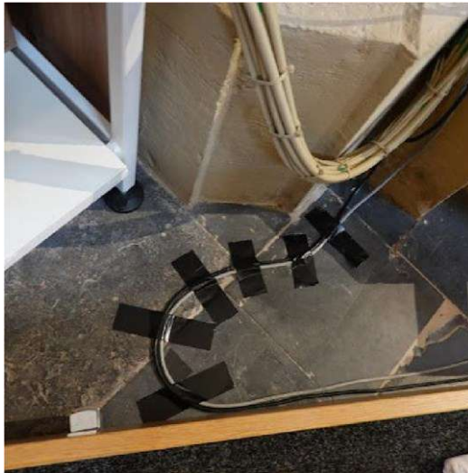
Elektrische draden met plakband op de vloer bevestigd
