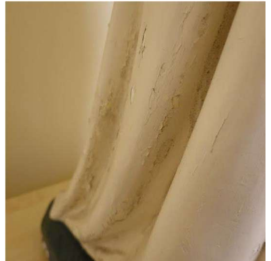
Mobiele opstuwingen en lacunes in de verflaag
