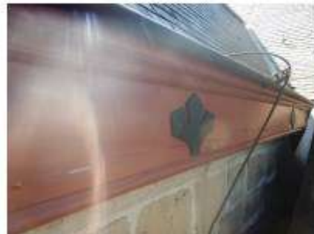
volume [3]-west: schilderwerk boordplank verweerd
