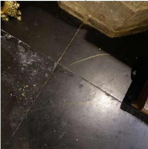
Lijmresten op de vloer onder tapijt
