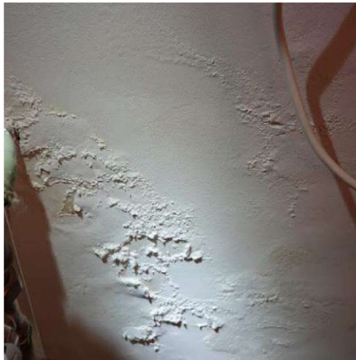
Vochtschade in de oostwand
