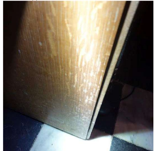
Oppervlakteschimmel (zuidelijke deur koor)
