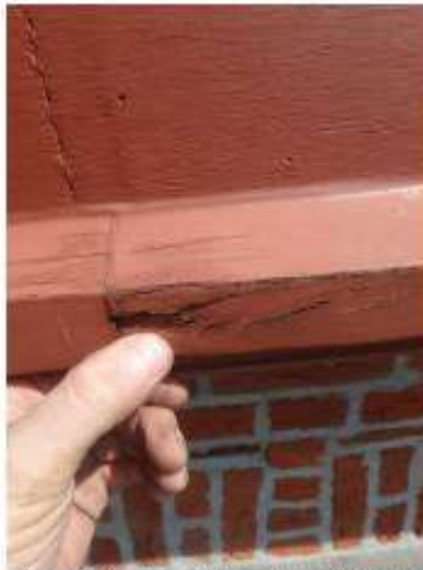
volume [10]-zuid: schilderwerk kroonlijst verweerd, stuk ingerot
