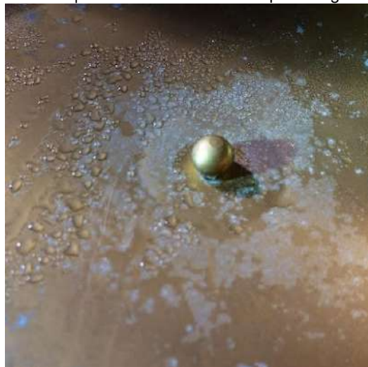
Condens en actieve corrosie
