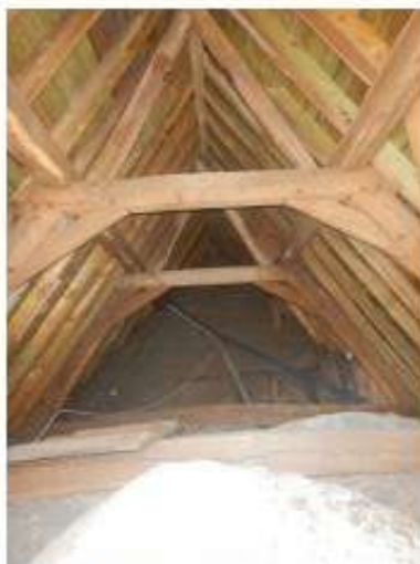
zolders [4] en [5]: geen loopbrug
