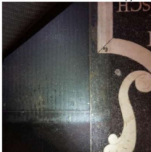
Schuurschade op de vloer door tapijt
