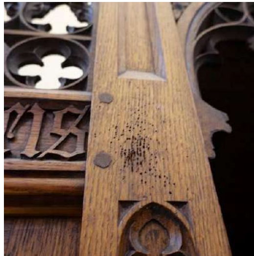
Schade door duimspijkers
