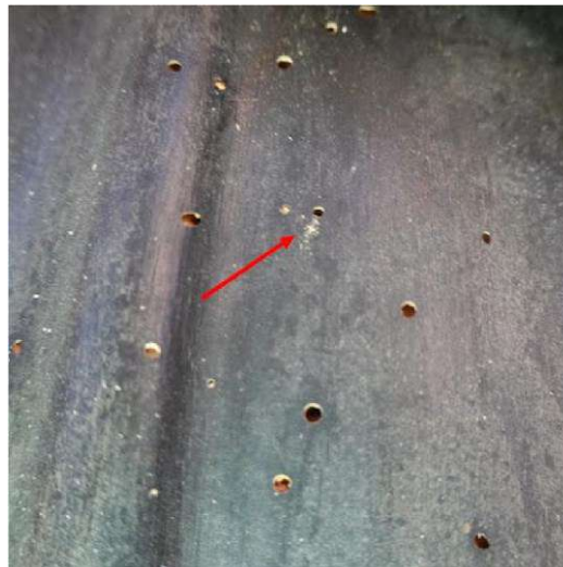
Uitvliegopeningen, op één plaats boormeel
