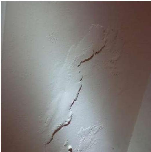
Vochtschade in de oostwand
