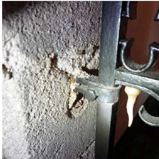
Verroest metaal t.h.v. de verankering in de muur
